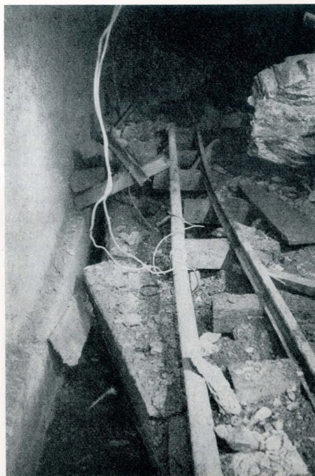
Fig. 4 - Effetti meccanici di un colpo di tensione (lo stesso di cui alla fig. 3): danneggiamenti al piede della galleria.
