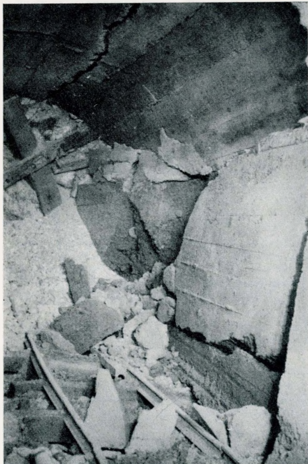
Fig. 3 - Effetti meccanici di un colpo di tensione su rivestimento in calcestruzzo (spessore 40 cm.) di galleria (rilassamento al XV livello, avanzamento Sud - zona Struggl, di Raibl, verificatosi il 13-6-1952 poco prima dello sparo delle mine: classificato come fortissimo , agì secondo la direzione del sistema di faglie Struggl e produsse un energetico scuotimento in tutti i cantieri compresi in un raggio di oltre 100 metri).
