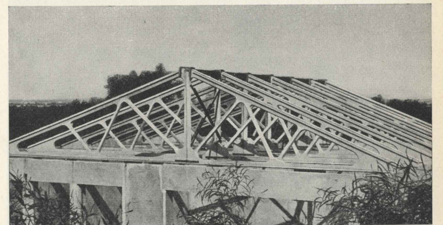
Fig. 14 - Capriate prefabbricate di c. a. per luce di ml. 8,60 in opera (Brevetto Sidercementi). Notare: la leggerezza, l'unione dei due pezzi con piastre e bulloni, le controventature provvisorie ed i piccoli casseri metallici in sommità per il getto del travetto di collegamento. Queste capriate sono asimmetriche perchè formate con l'accoppiamento di due elementi differenti: ciò permette di ottenere molte lunghezze con un limitato numero di tipi di mezze capriate.
