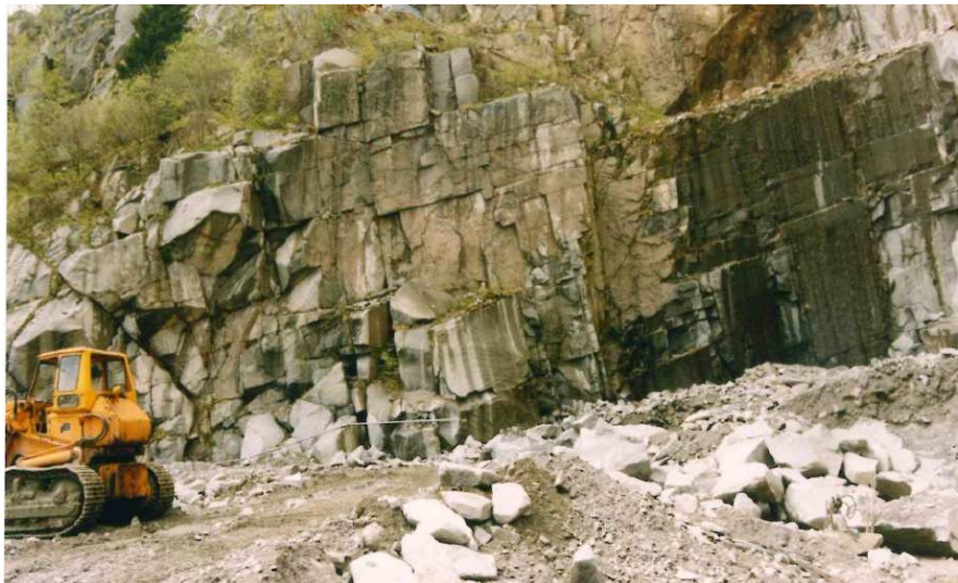
Fig. 2: Dettaglio del fronte in sinistra, con la parete rocciosa intensamente fratturata ed il cumulo detritico alla base
