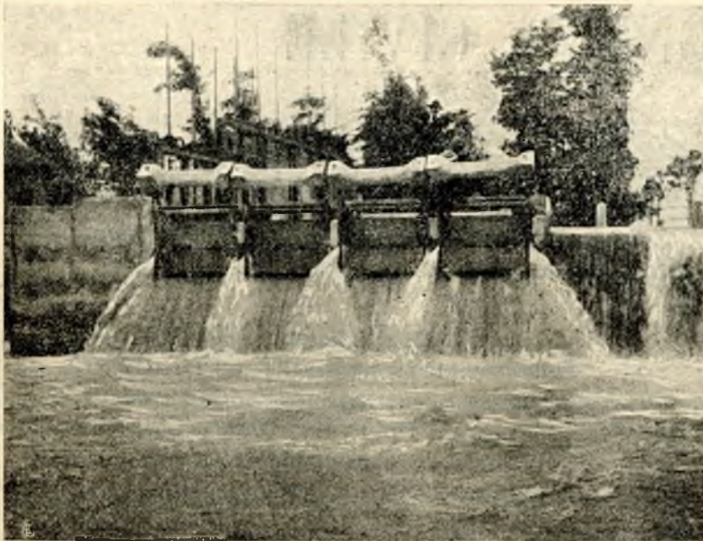
Fig. 108. — Paratoie autolivellatrici a pendolo, applicate sul canale Quintino Sella (da fotografia).
