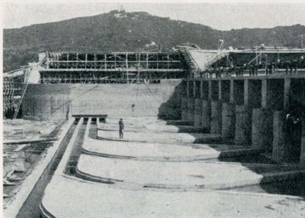
Fig. 6 - Tramogge di sghiaiatore a valle delle luci di presa.
