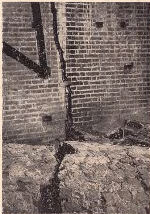
d) Grande e pericolosa spaccatura in una volta e in un muro perimetrale, che dopo il restauro non desta più preoccupazioni, ma resta a testimoniare il dissesto avvenuto.
