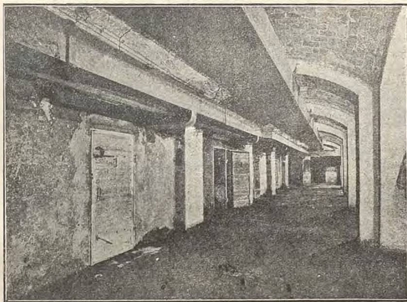
Fig. 1327 b. — Salone e celle dell'impianto frigorifero dei Magazzini Generali di Roma.
