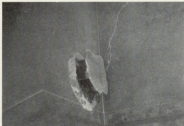
Fig. 4 - Effetti del calore sulle travi di ferro di sostegno dei solai. La pericolosità del metallo nelle strutture portanti deriva dalla sua grande dilatabilità e dalla perdita di elasticità e di resistenza meccanica.
