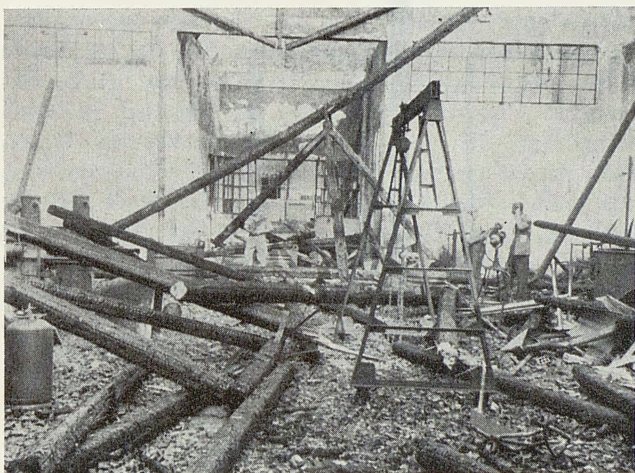
Fig. 6 - Effetti dell'incendio scoppiato in uno stabilimento industriale per la lavorazione dell'alluminio, mediante stampaggio con pressofusione. Si possono notare le strutture portanti del tetto, in legno, completamente carbonizzate. Il crollo di tutta la copertura contribuì a rendere catastrofica l'incendio, iniziato con una perdita di nafta da uno dei forni di fusione dell'alluminio.
