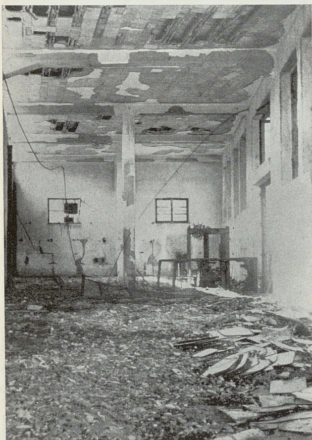
Fig. 3 - Il cemento armato offre la massima resistenza al fuoco fra tutti i diversi materiali da costruzione. In questo mobilificio i laterizi forati del tetto crollarono dopo circa 1/2 ora dall'inizio dell'incendio, mentre i pilastri di cemento armato non risultarono sensibilmente danneggiati.
