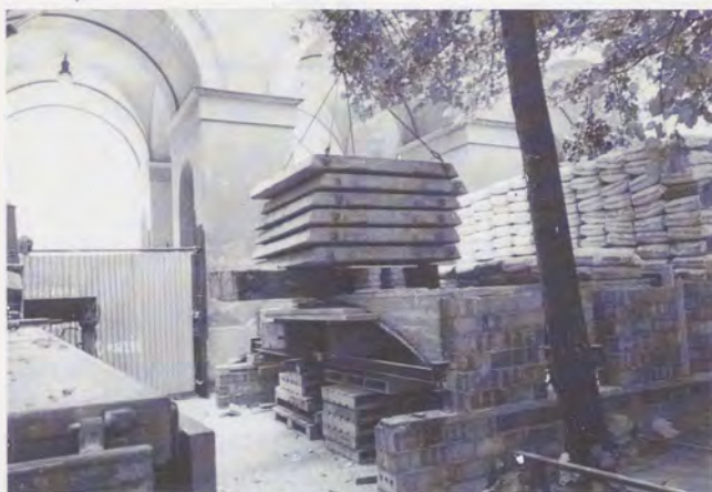
Fig. 6 - La volta consolidata con calotta di vetroresina armata non è andata a rottura sotto un carico concentrato in chiave pari a 7 t, perché prima hanno ceduto i robusti ancoraggi degli incatenamenti.
