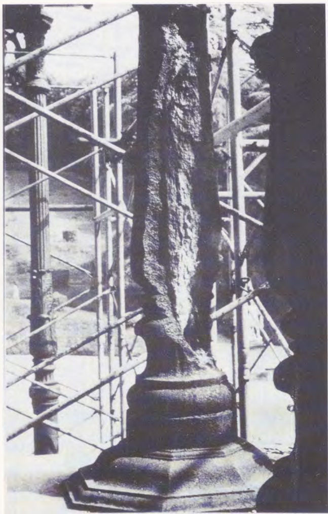
Fig. 17 - Particolare dell'ampio distacco di materiale manifestato dal fusto di una colonna di ghisa, prodotto da autotensioni latenti nel getto (Palazzina «La Meridiana» a Firenze, 1874).
