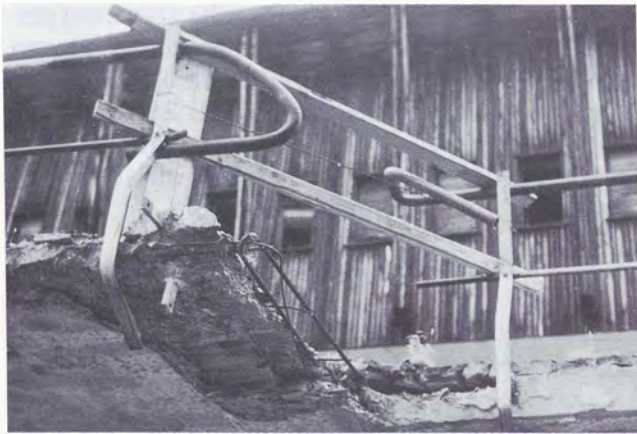
Fig. 5 - Rilievo dello stato di degrado della stazione nel 1989.
