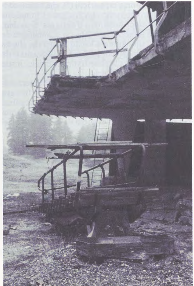
Fig. 6 - Particolari della terrazza dopo il crollo della scala.
